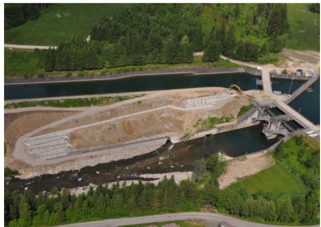
Die insgesamt rd. 435 m lange Organismenwanderhilfe beim Wehr Rottau verbindet das Restwassergerinne der Möll mit dem oberwasserseitigen Ausgleichsbecken des Kraftwerks Malta Hauptstufe bzw. dem Oberwasserkanal der Malta Unterstufe - hier kurz vor Baufertigstellung (Quelle: VHP 2013).
